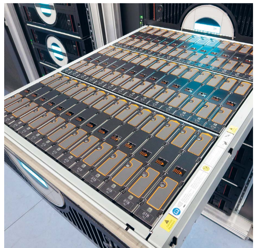
Festplatten in der »Large Scale Data Facility 2«. Foto: Mattes, URZ
